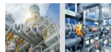
プラント配管
